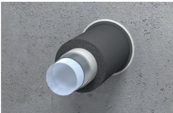
Ggf. Kontrolle der Abschottung.
